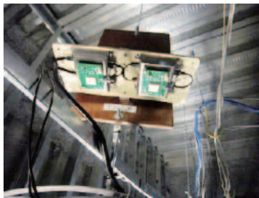
天井内部のIMES送信機 (測位衛星技術株式会社提供)
